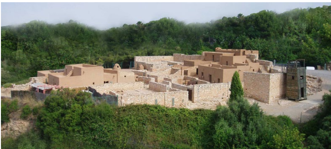
Figura 5. Vista general de la Ciutadella Ibèrica amb els recintes interpretats arquitectònicament a punt de finalitzar
